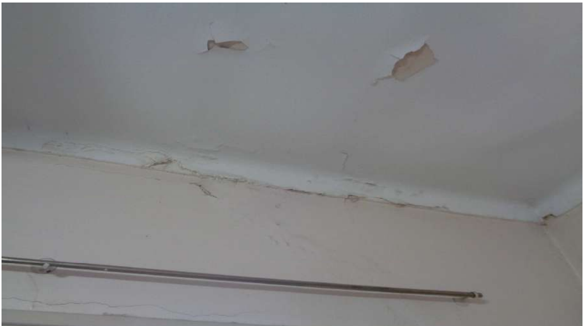
Revestimiento y ventiluz deteriorado por filtraciones a través de las grietas entre la loza y las paredes laterales
