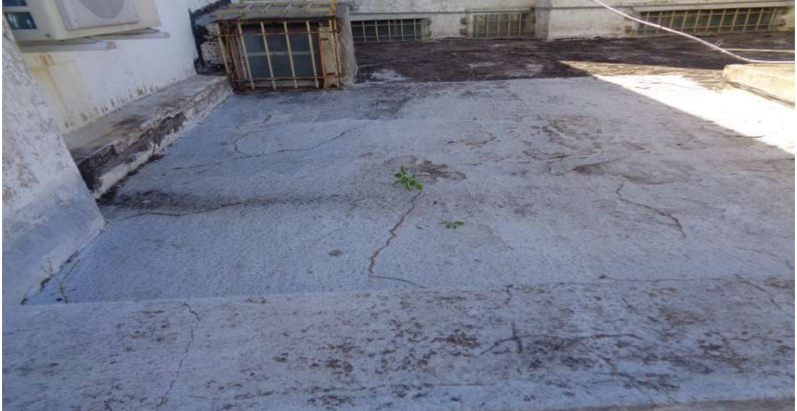
Cielorraso y paredes afectadas por filtraciones a través de las grietas en la loza
